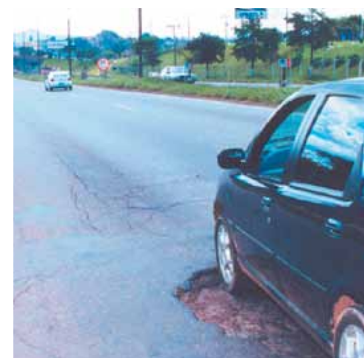
Automóvel dentro de um buraco na estrada.
